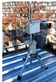
屋外用無線通信装置
