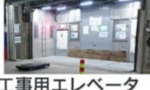
工事用エレベータ
